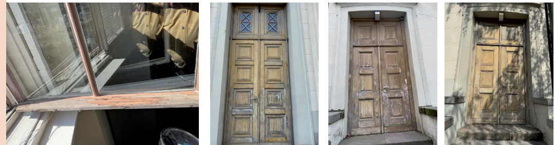
Sanierungsbedürftige Fenster und Türen in St. Paul
